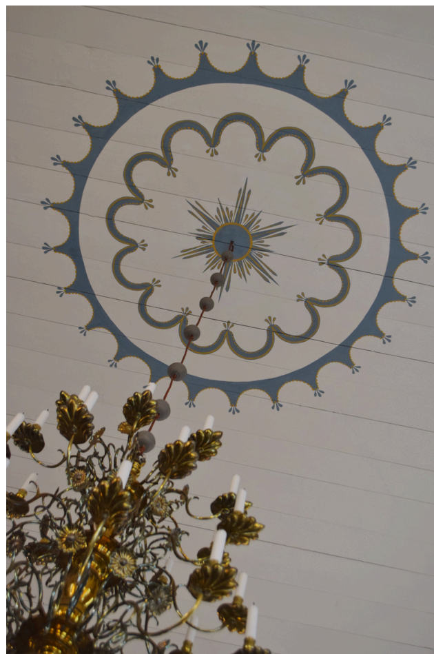
Takmålningen som upptäcktes i samband med renoveringen 2000-2002.
